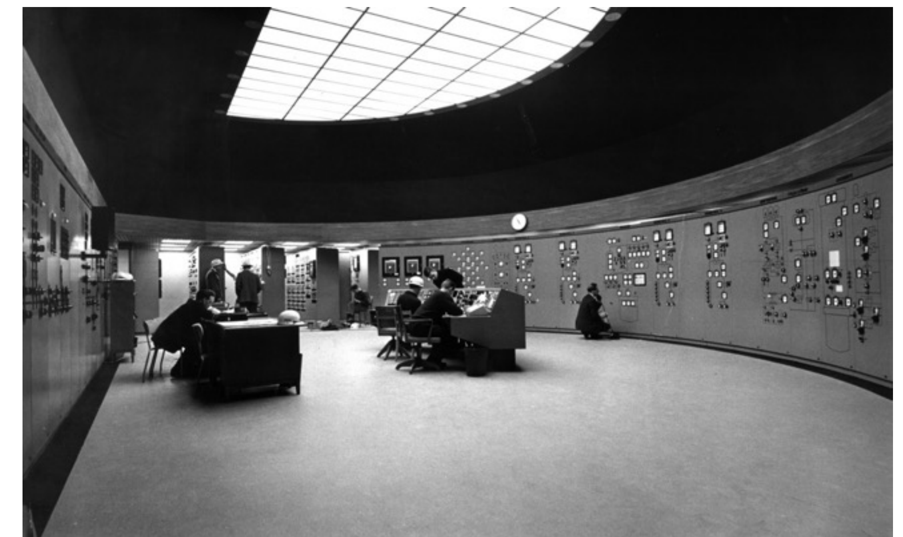
Sterownia elektrowni Ågesta
